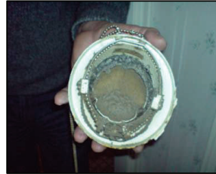
Gjengrodd ventil på bad
