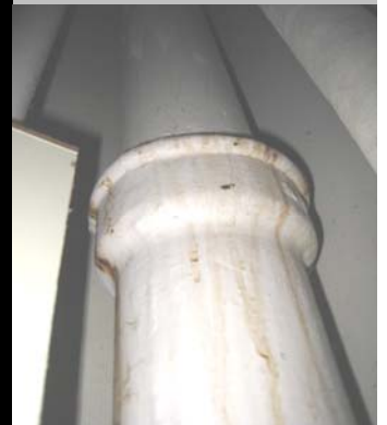
Bildet viser rustrenner fra rustskadet rør og muffe som "svetter"
